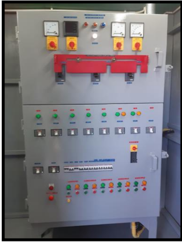
ตู้ควบคุม
