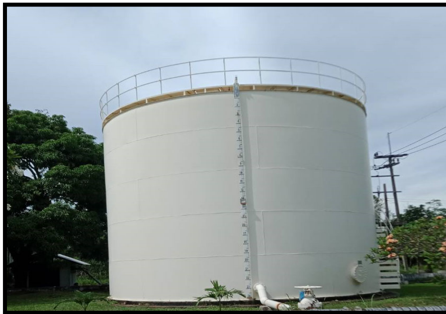
รูปภาพ : ถังเก็บน้ำ สฟ.ทร. ( พื้นที่สัตหีบ ) ขนาด 1,500 ลบ.ม.
